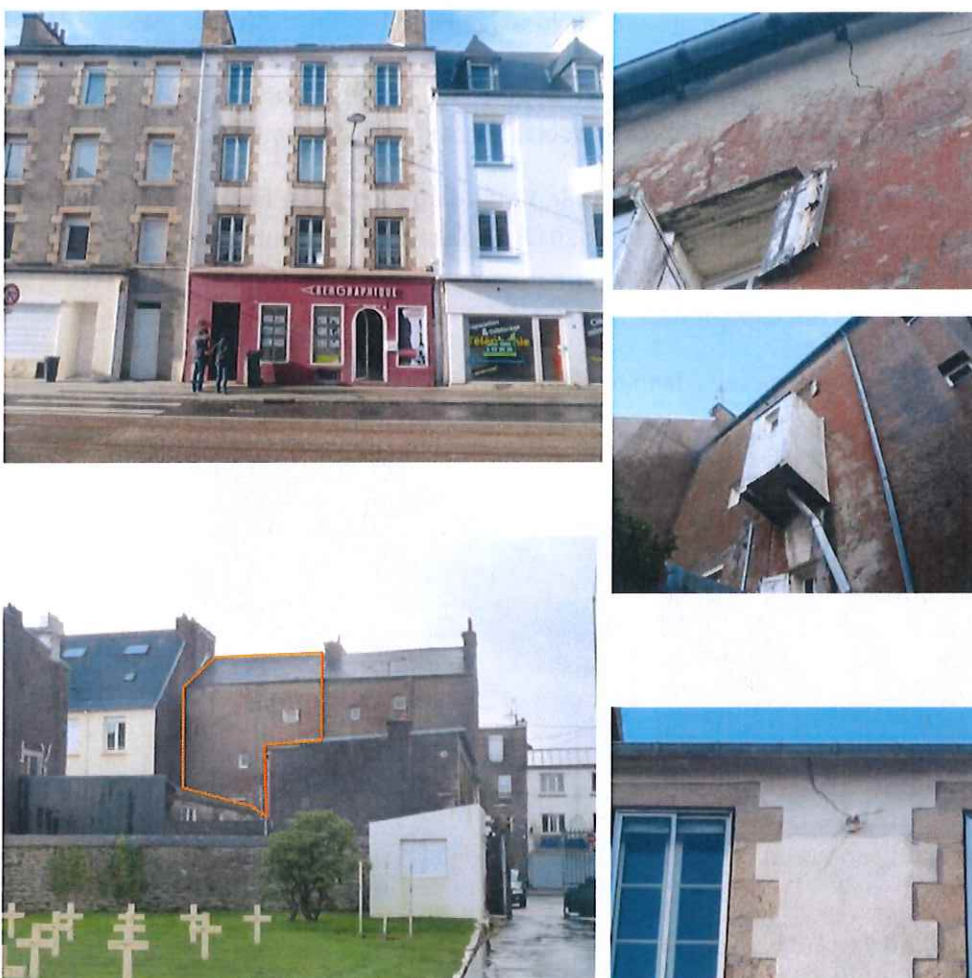
Vues sur l'immeuble n°224, bâti formant un ensemble homogène avec le n°222. Des désordres structurels se retrouvent à plusieurs endroits du bâtiment.
